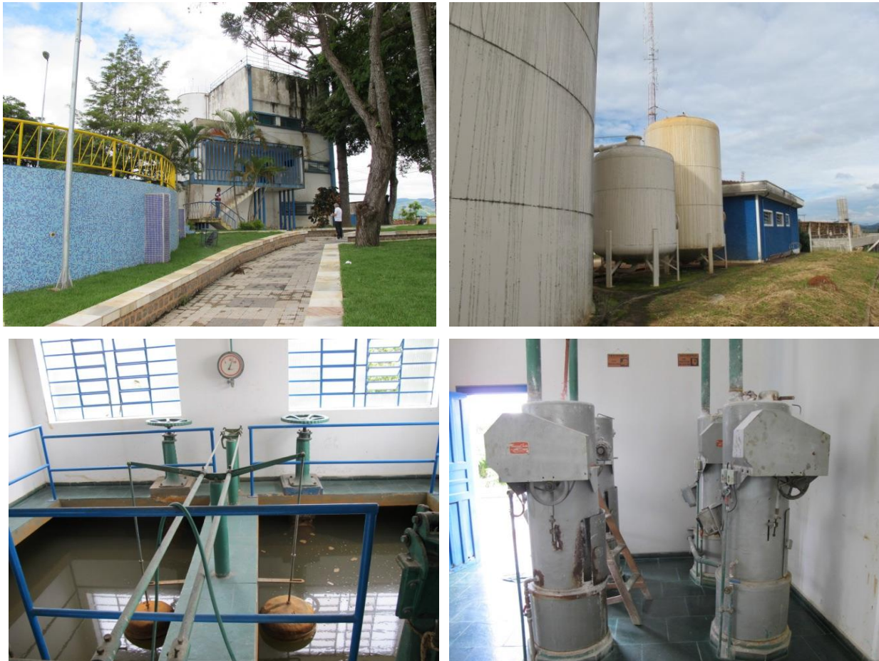
Figura 51: Acima ETA I e ETA II. Abaixo sistema de filtros da ETA I.
