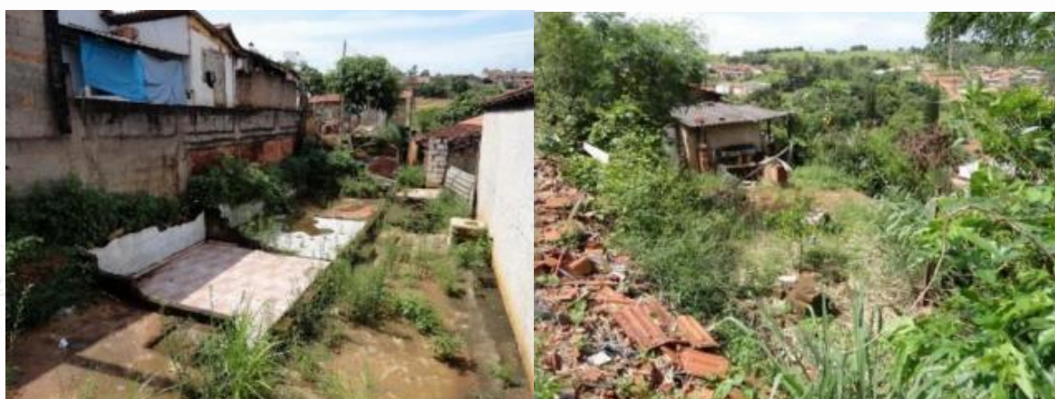
Restos de uma moradia removida pela prefeitura e moradia inserida em área de risco (IPT, 2015).
