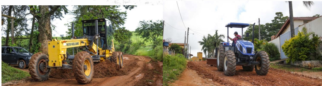
Problemas relativos à erosão e atolamento nas estradas rurais, e dos serviços realizados pela municipalidade FONTE: Prefeitura Municipal de Caconde (2023)
