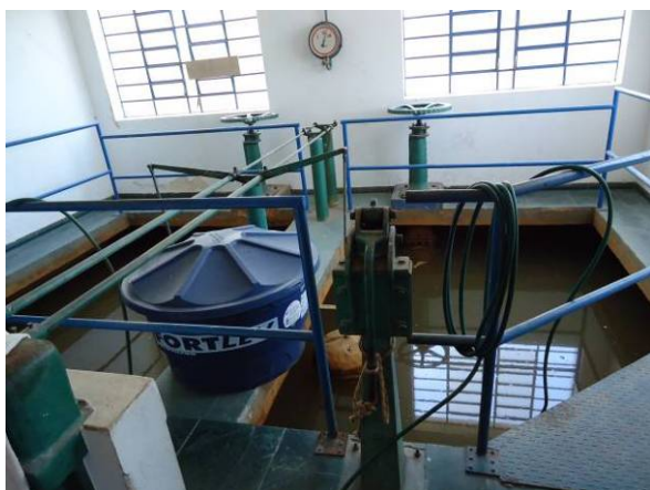
Figura 23. Vista dos Filtros
