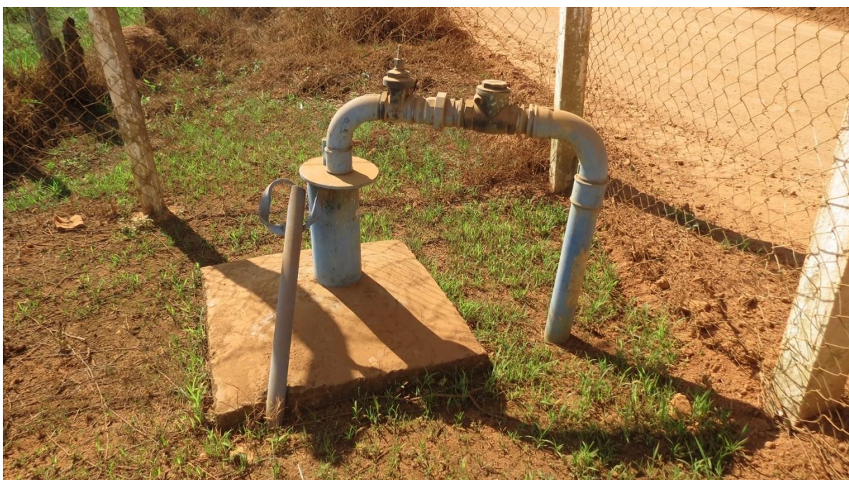
Figuras 36 – Poço que abastece o Distrito de Barrânia
