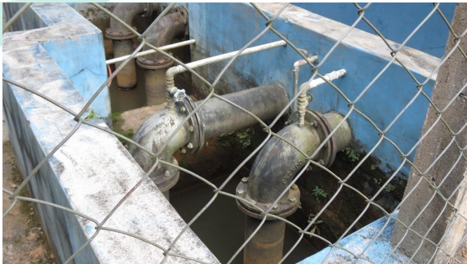
Figura 44 Adutoras de água bruta
