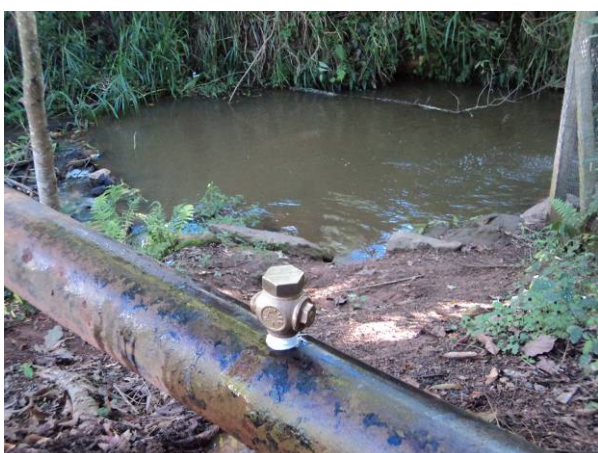
Figura 95. Vista da Estação Pitométrica Instalada
