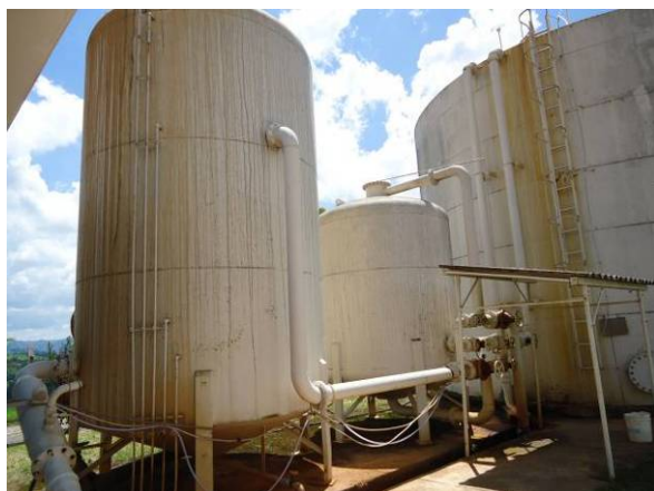
Figura 30. Vista da ETA II
