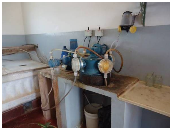
Figura 32. Vista das bombas dosadoras de produtos químicos
