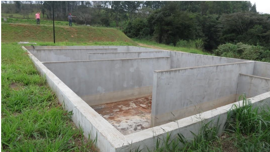
Figura 79 – Tanques de Contato.
