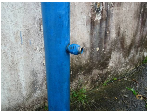
Figura 91. Vista da Estação Pitométrica Existente
