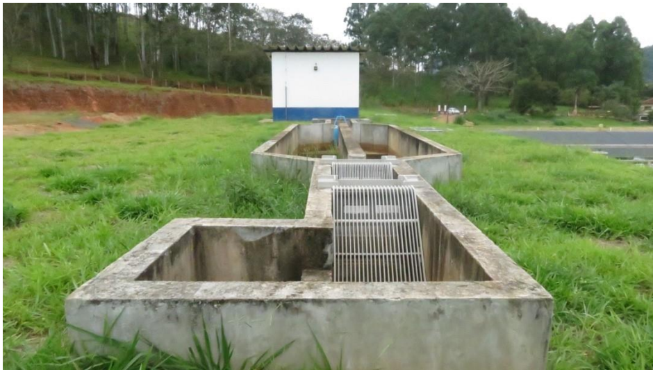
Figura 73 –Pré tratamento de esgoto, gradeamento, caixa de areia e calha Parshall.
