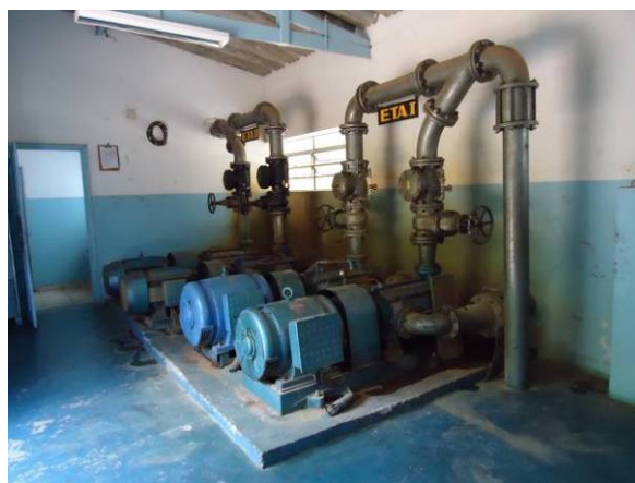
Figura 12. Vista dos Conjuntos Motor-Bomba
