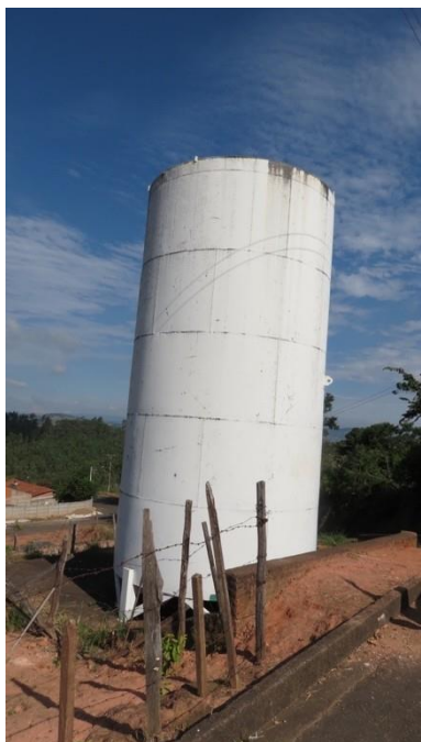
Figura 60 – Reservatório São José (100 mil L)
