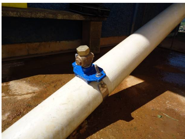
Figura 93. Vista da Estação Pitométrica Instalada
