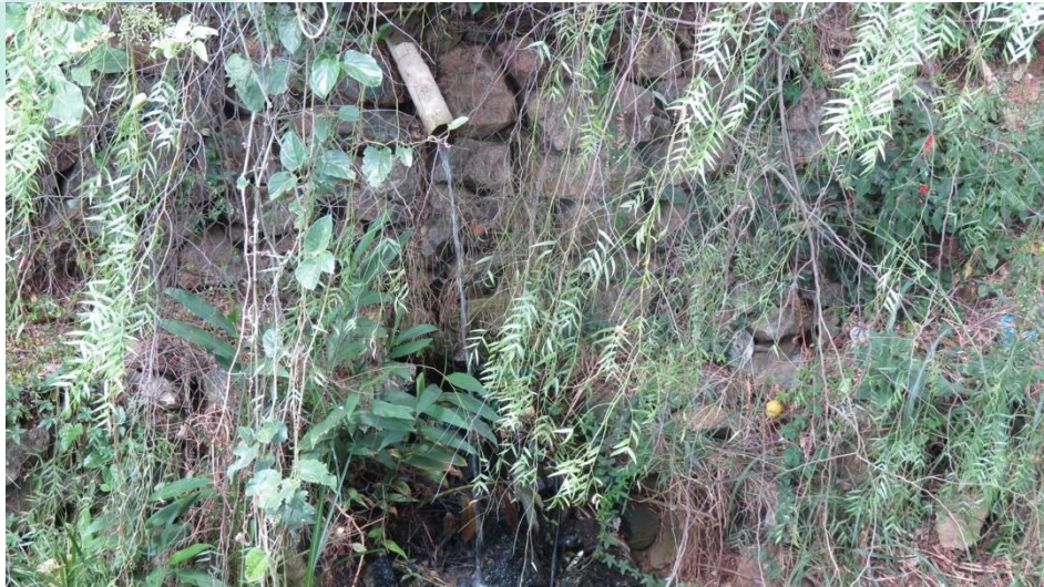
Figura 70 – Lançamento de esgoto Córrego São Miguel.
