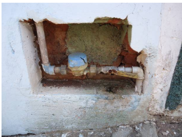
Figura 115. Vista do Hidrômetro na Rua Pio XV, nº 114
