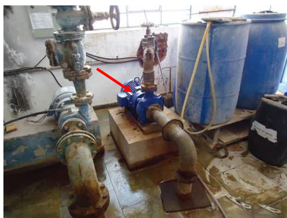
Figura 29. Vista do Conjunto Motor-Bomba que recalca água para o R03
