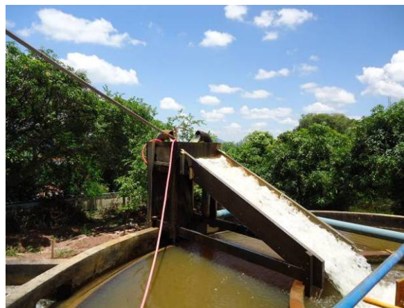
Figura 22. Vista da Chegada da água bruta na ETA I
