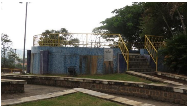
Figura 54 – Reservatório junto a ETA I (380 mil L)
