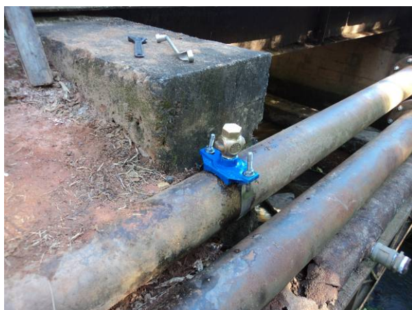
Figura 97. Vista da Estação Pitométrica Instalada
