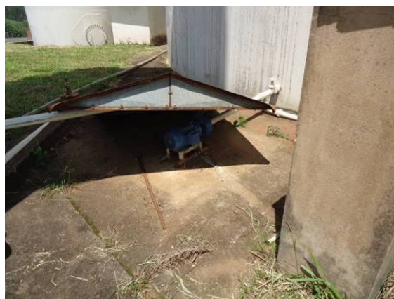
Figura 35. Vista do conjunto motor-bomba que recalca água do R04 para o R06
