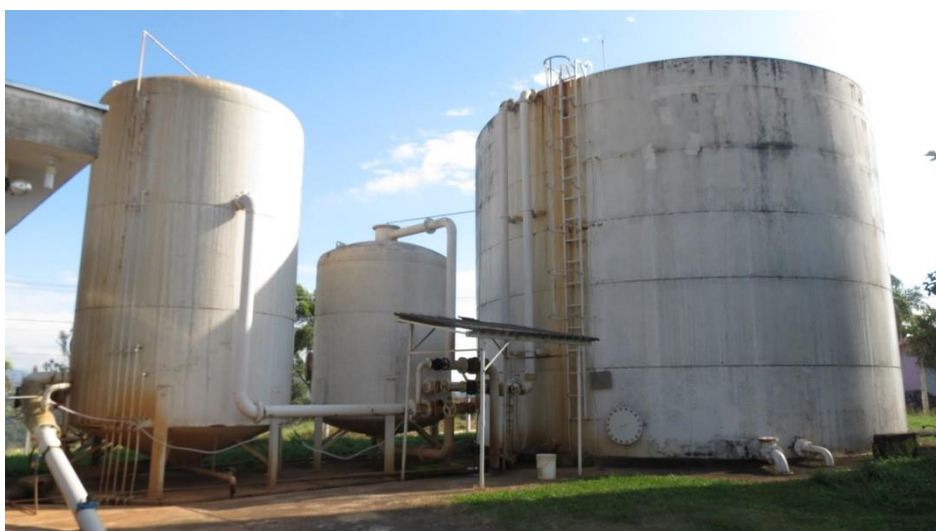
Figura 51 – Decantador, filtro e reservatório ETA II
