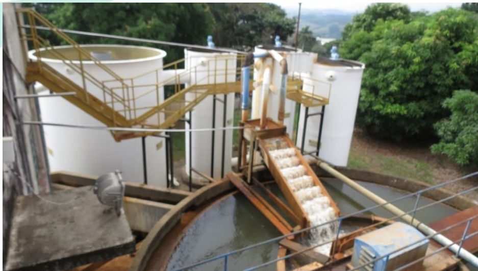
Figura 48 – Ao fundo 3 tanques de floculação, um tanque de decantação, escada de aeração, em frente tanque de floculação e decantação conjuntos.
