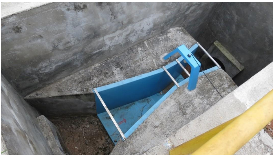
Figura 80 – Calha Parshall após o tratamento.
