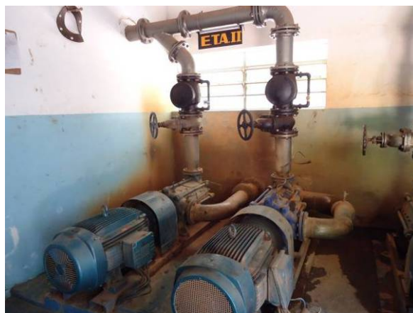
Figura 14. Vista do Conjunto Motor-Bomba que recalca água para a ETA II
