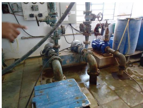
Figura 27. Vista dos conjuntos motor-bomba
