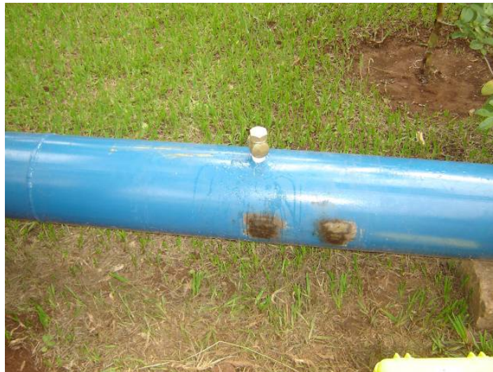
Figura 75. Estação Pitométrica (EP) instalada em uma tubulação de água
