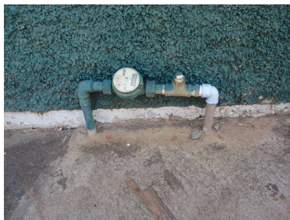
Figura 114. Vista do Hidrômetro na Rua Pio XV, nº 100
