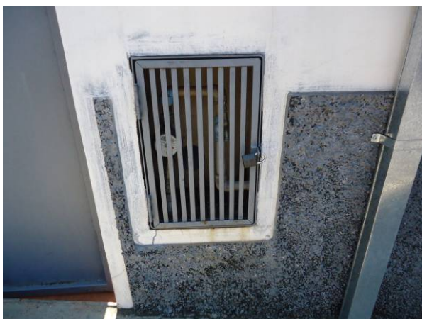
Figura 109. Vista do Hidrômetro na Rua Marechal Deodoro, nº 183 A
