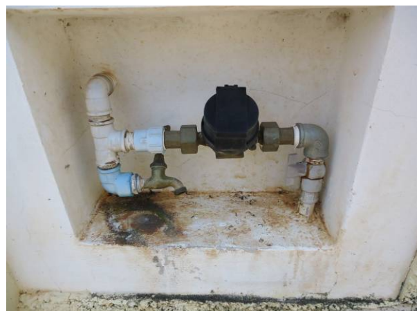
Figura 110. Vista do Hidrômetro na Rua Marechal Deodoro, nº 205 A
