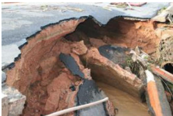
Figura 123 – Córrego dos Cristais – Enchente 12/2012
