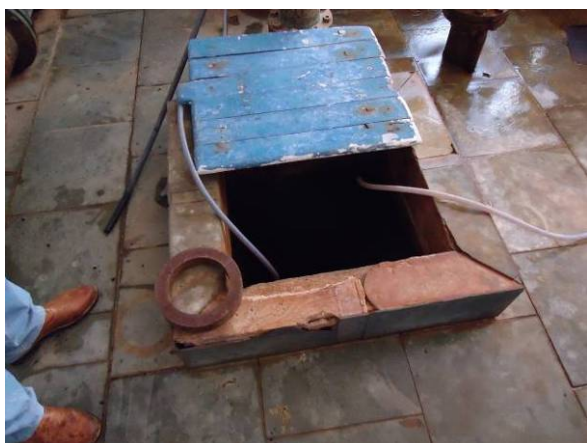
Figura 26. Vista do Reservatório de Sucção
