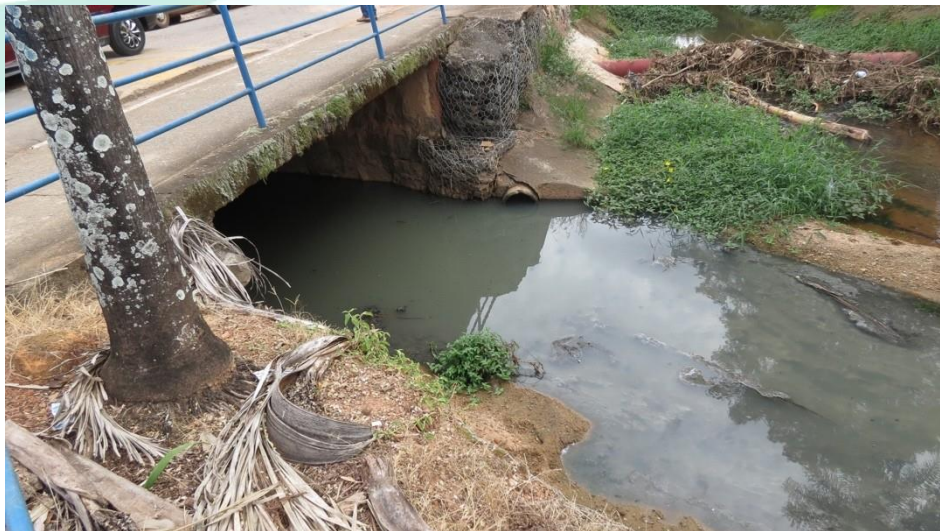
Figura 67 – Lançamento de esgoto Córrego São Miguel.
