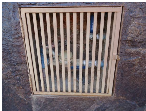
Figura 116. Vista do Hidrômetro na Rua Sebastião Correia, nº.27
