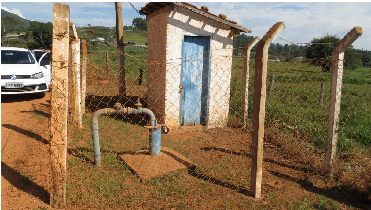
Figuras 35 Poço que abastece o Distrito de Barrânia
