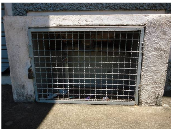
Figura 113. Vista do Hidrômetro na Rua Niterói, nº 51
