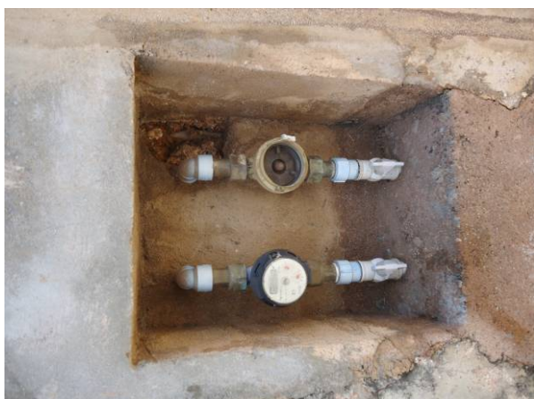
Figura 111. Vista do Hidrômetro na Rua Nabor Ribeiro, nº 50
