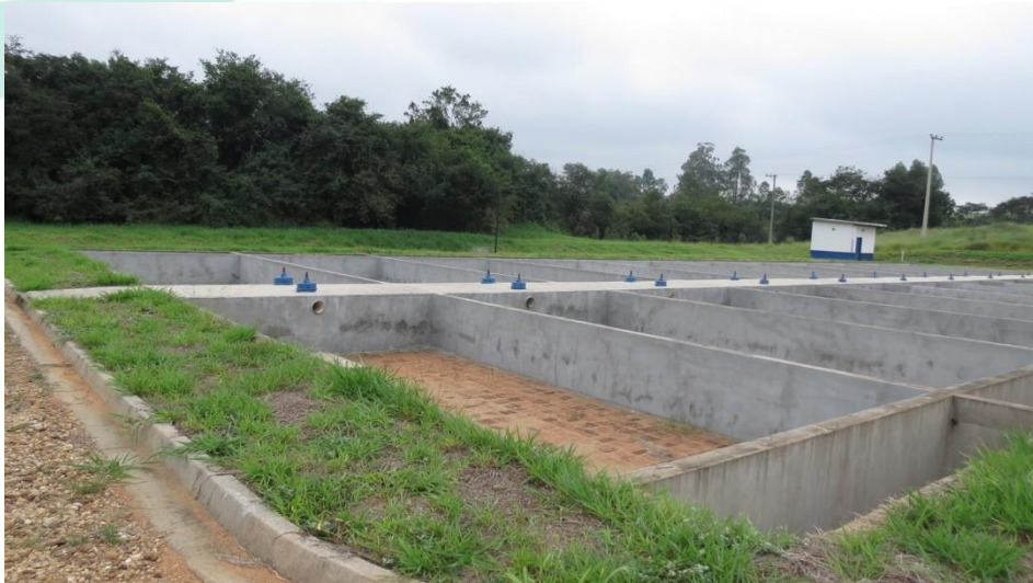
Figura 78 – Leitões de Secagem de Lodo.
