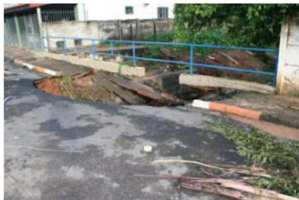
Figura 122 – Córrego dos Cristais – Enchente 12/2012
