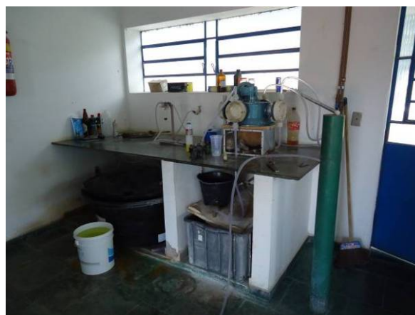
Figura 24. Vista das dosadoras
