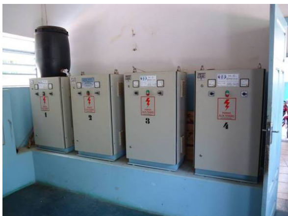
Figura 15. Vista dos Painéis Elétricos
