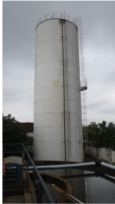
Figura 56 – Reservatório junto a ETA I (500 mil L)
