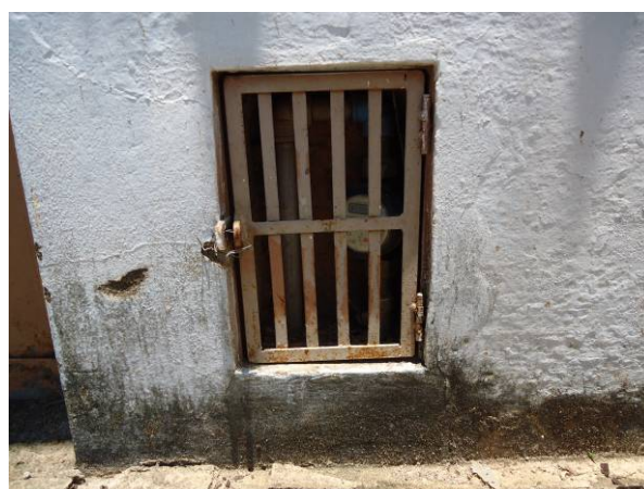
Figura 104. Vista do Hidrômetro na Rua Amador Ribeiro, ao lado do nº 125
