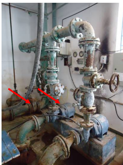
Figura 28. Vista dos Conjuntos Motor Bomba que recalcam água para o R01
