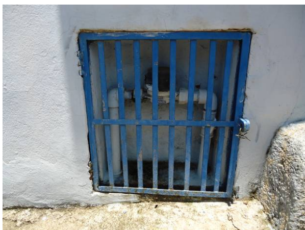
Figura 101. Vista do Hidrômetro na Rua Amador Ribeiro, ao lado do nº 125
