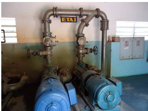
Figura 13. Vista do Conjunto Motor-Bomba que recalca água para a ETA I
