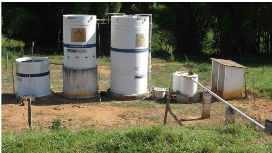
Figura 83– ETE do Loteamento CDHU paralisada.
