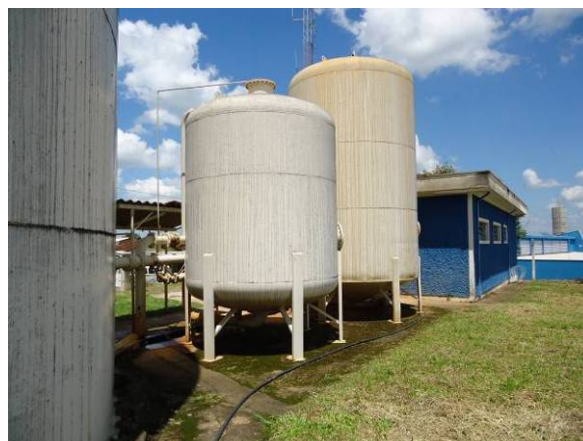
Figura 31. Vista da ETA II
