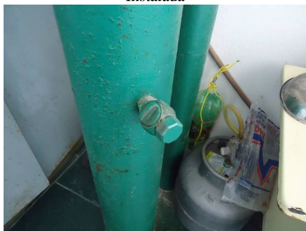
Figura 99. Vista da Estação Pitométrica Existente
