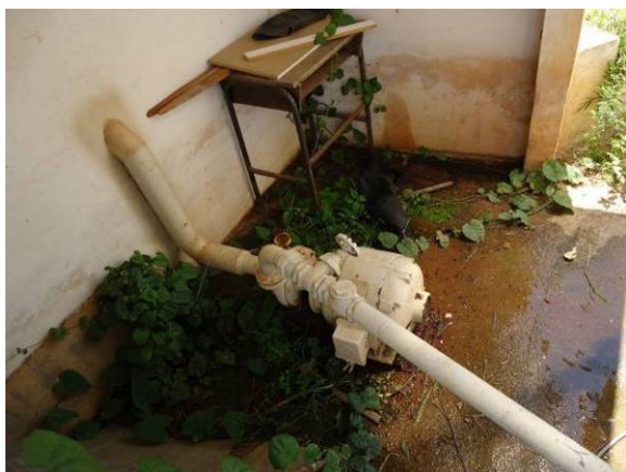
Figura 34. Vista do conjunto motor-bomba que recalca água do R04 para o R05
